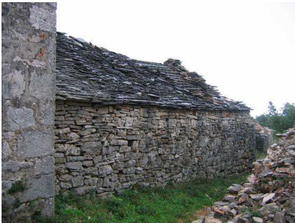
Sl.10: Ruševna gospodarska kućica prije obnove (foto: S. Buble, 2006.)
